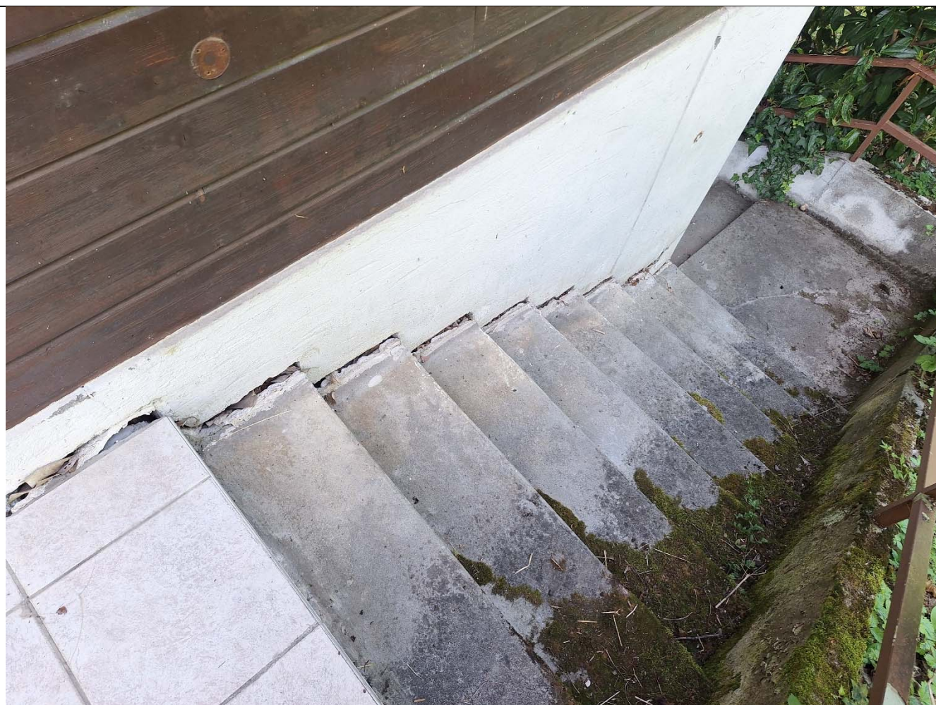
Photo 4 – Fissures le long de l'escaliers de la bâtisse de la parcelle 156
