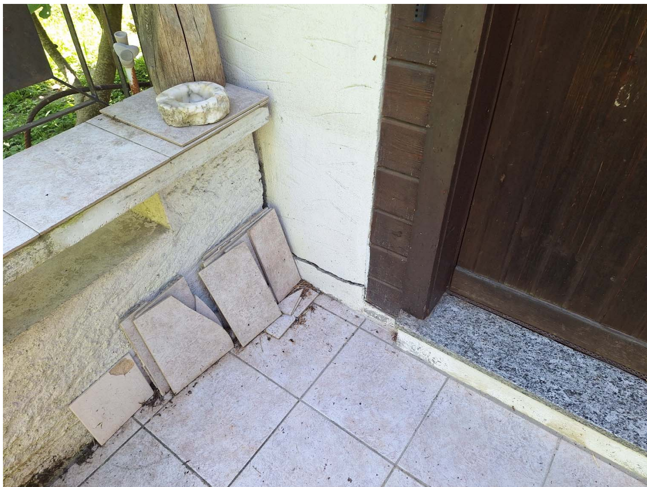
Photo 3 –fissures sur la bâtisse de la parcelle 156
