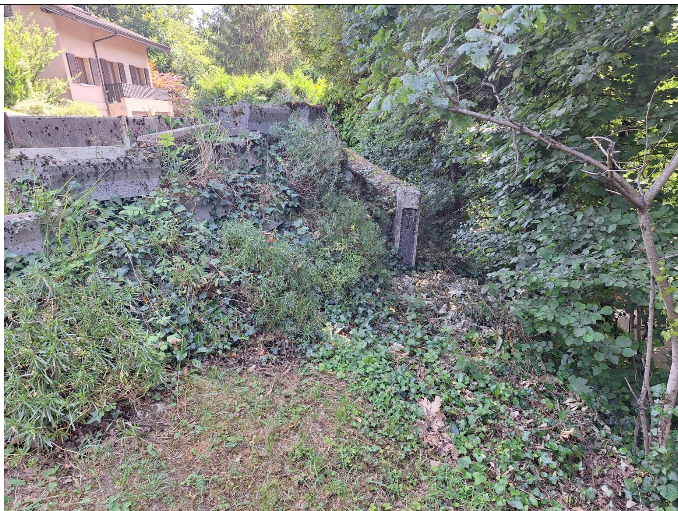
Photo 6 – Mur penché en face du garage.
