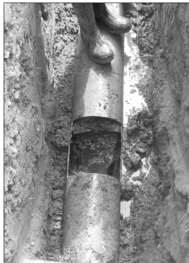
Tuyaux bouchés, réseau à entretenir.
