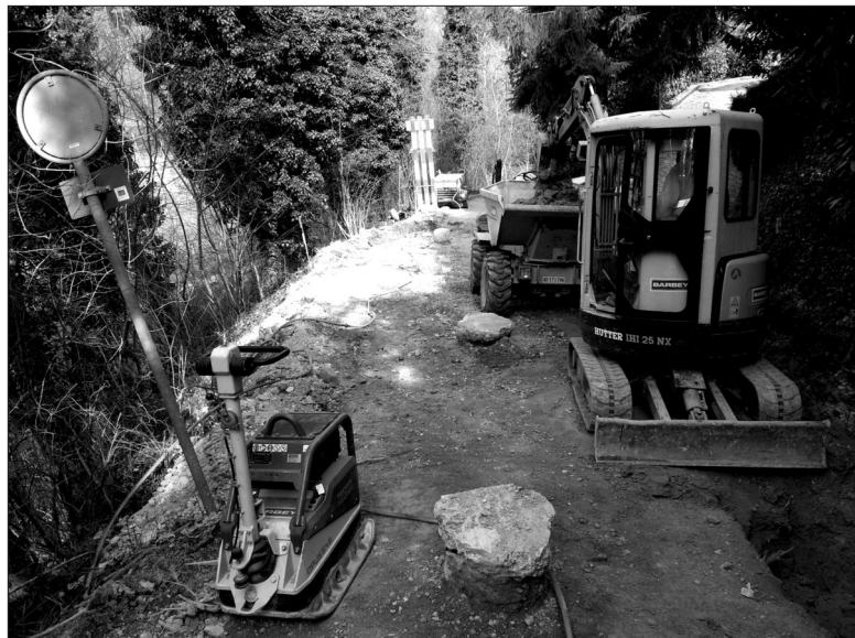
Un chemin délabré à refaire entièrement.
