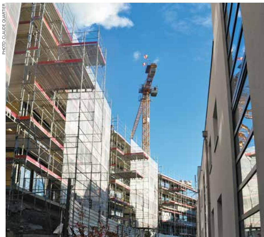
Le Vallon de la Paudèze en construction. Il aura fallu dix ans pour en arriver là.
